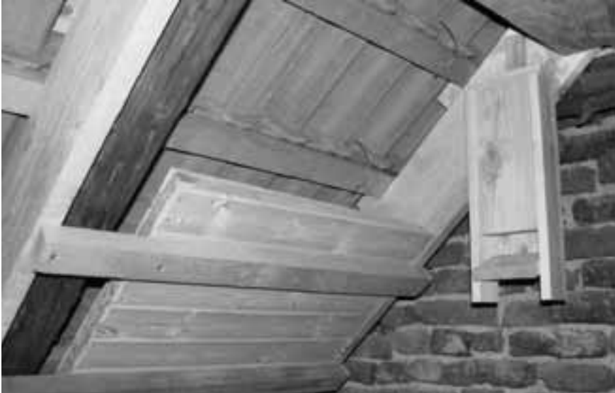
Verschiedene Fledermausflachkästen im Dach
